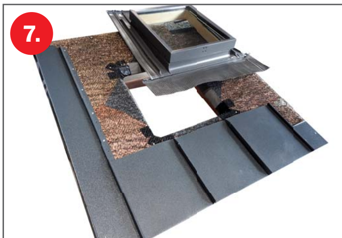
7. Příprava krytiny kolem výlezu. Montáž je možná jak z levé, tak z pravé strany. Úprava dílů krytiny pod výlezem.
