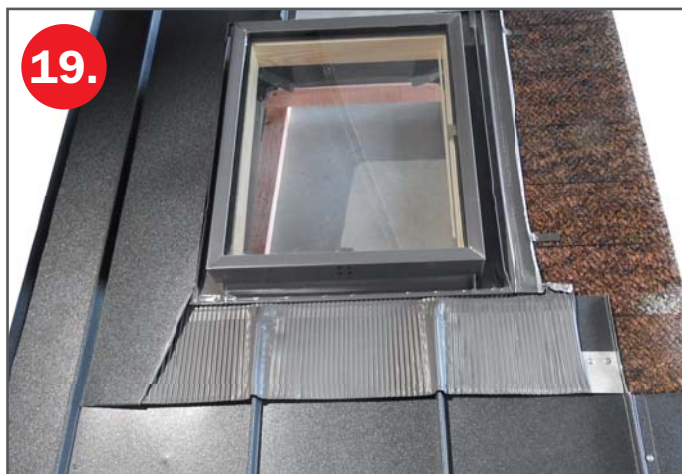
19. Osazení bočního dílu krytiny. Na druhé straně výlezu se postupuje shodně, ale až po instalaci krytiny nad výlezem
